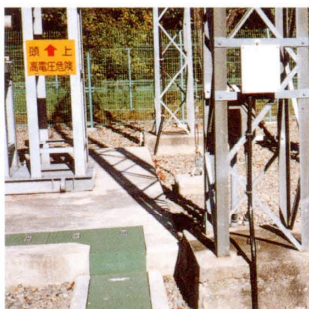
発電所・変電所
